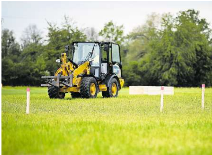
Auf dem Schwingfest-Gelände im Westen der Stadt Zug sind die Bagger aufgeföhren. Zurzeit laufen Vorarbeiten.
