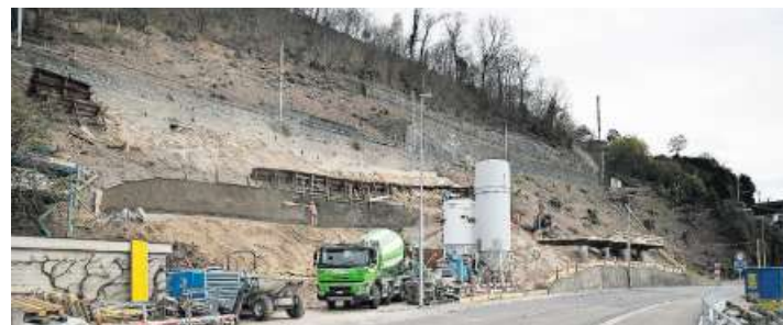
Anfang April wurde mit dem Bau des Installationsplatzes zwischen Lothenbach und Hörndli in Walchwil begonnen. Bild: Stefan Kaiser
